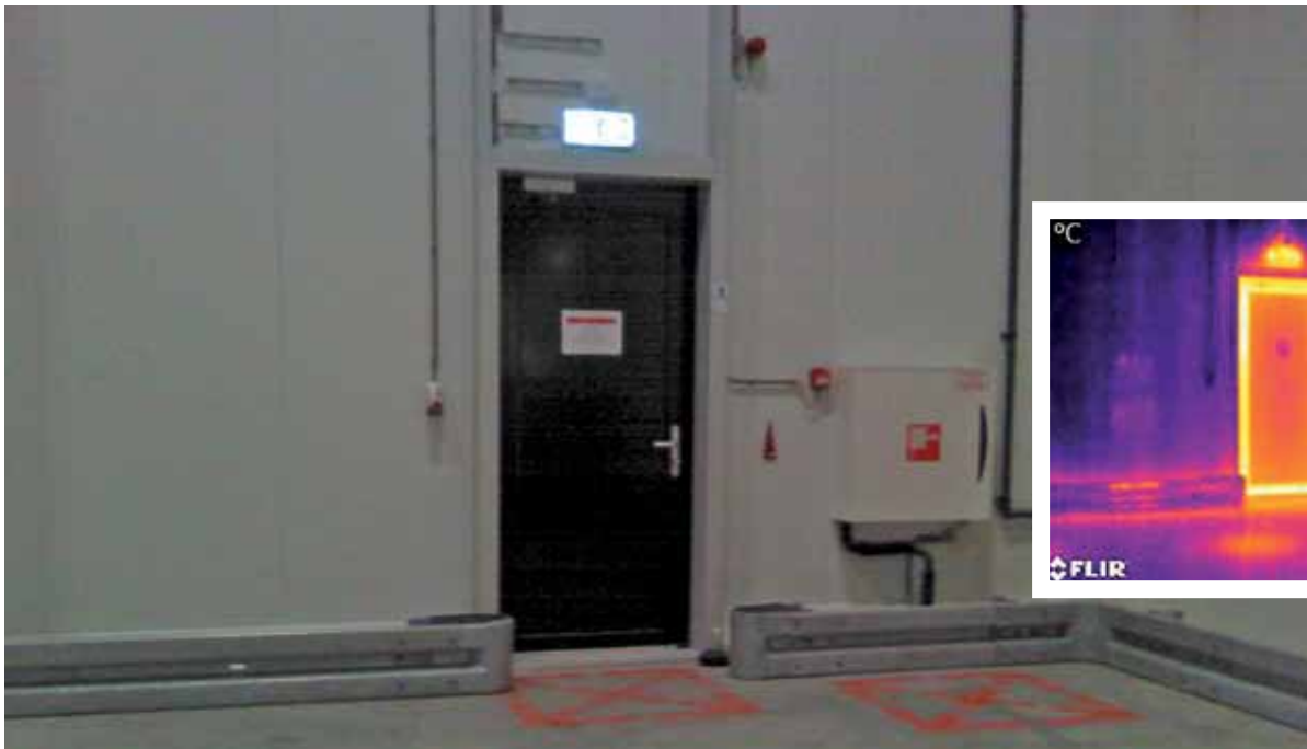
Situatie 1: Nooddeur in een koelhuis uitgevoerd in aluminium, sandwichpanelen met stalen huid.
