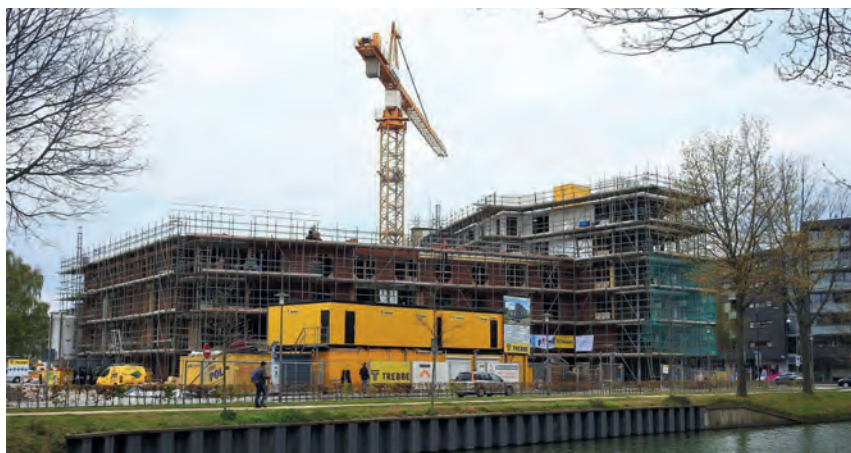
Voor de bouw van de 86 zorgappartementen in Apeldoorn zijn er verschillende verwarmingsmethoden vergeleken en doorgerekend. Passief bouwen kwam als beste uit de bus.
