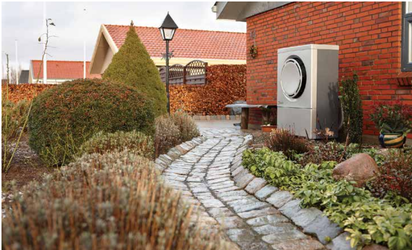
Volgens de meeste partijen zijn ook installaties noodzakelijk voor de stap naar een A-label.
