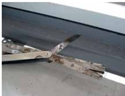
Stelkozijnen zijn niet luchtdicht op elkaar aangesloten; 'waar een luchttek is, is een waterlek'.
