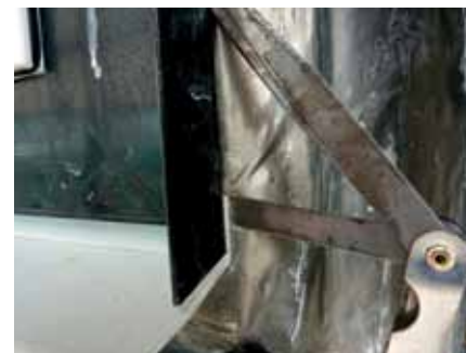
Mogelijk capillair vochttransport door onvoldoende aansluiting van geveldelen.
