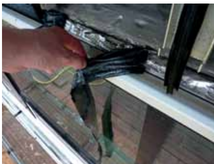
Waterdichte lagen zijn onvoldoende verkleefd.
