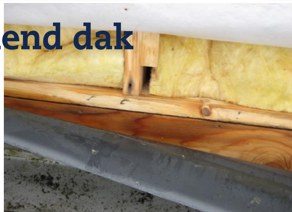
Gebrekkige luchtdichting dakvoet leidt tot vochttopbouw.
