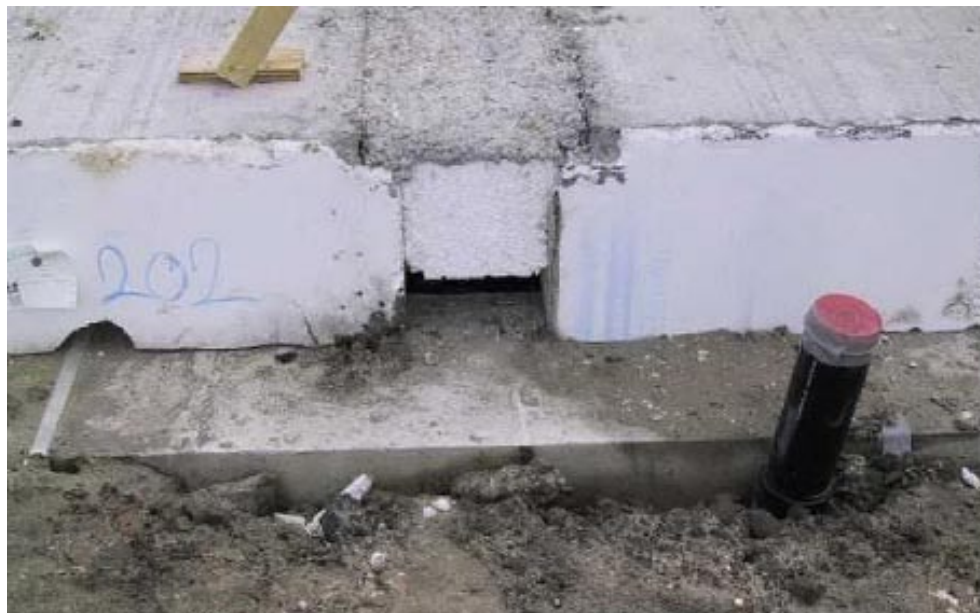
De ruimte onder de passtroken is niet afgedicht. Hierdoor kan kruipruimtelucht de woning binnendringen.
