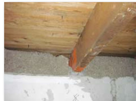
Ter plaatse van de balk en tussen wand en dakbeschoot is sprake van naden, waardoor een brand ongehinderd naar het naastliggende compartiment kan uitbreiden.
