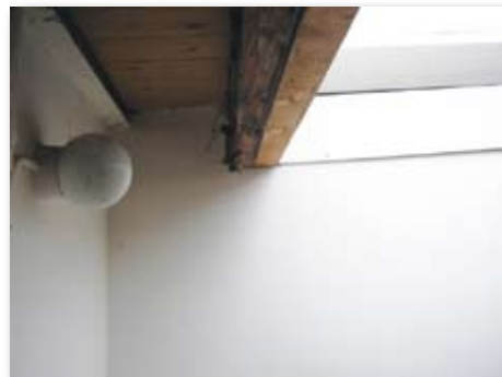
Ter plaatse van daklichten kan een brand eventueel brandbare dakisolatie bereiken en zich verspreiden. Daarnaast kan via het daklicht brandoverslag optreden (uitslaande vlam) naar naastgelegen gevels.
