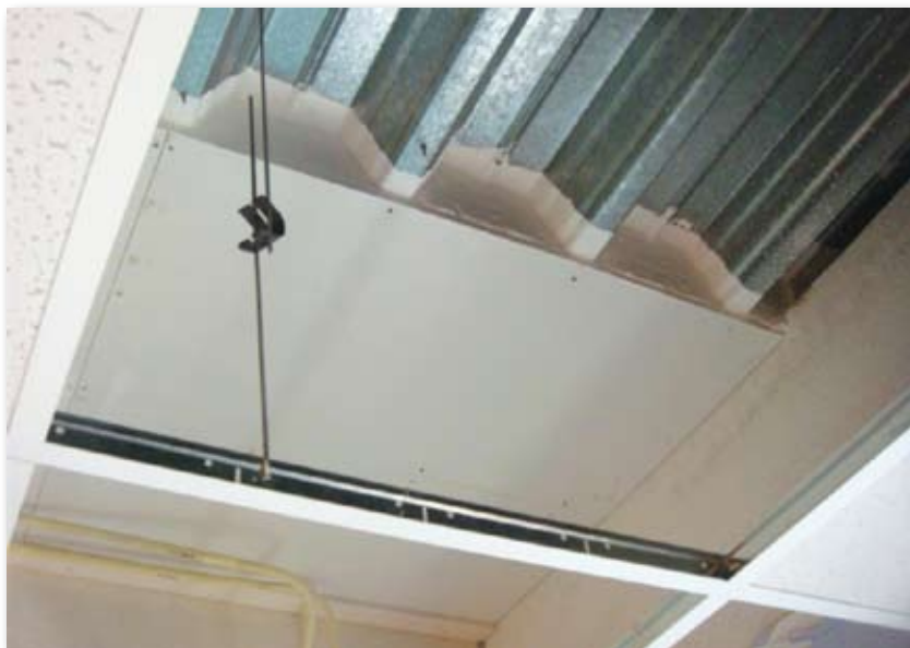
Bij een stalen dakplaat over een brandscheiding kan branddoorslag en brandoverslag worden voorkomen door toepassing van een vlamscherm (brandwerende plaat onder de dakplaat) en cannelurevulling.
