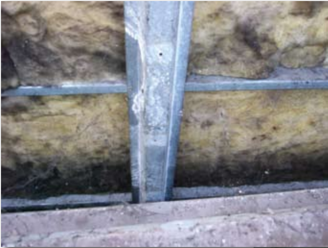
Verzinktstalen achterconstructie in de spouw van een 25 jaar oud gebouw.
