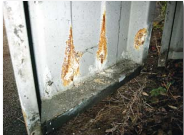
Ingesloten vocht in de spouw heeft een duidelijk negatieve invloed op de duurzaamheid van de hier toegepaste materialen.
