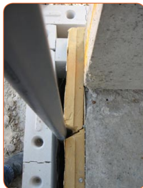
Foto 1. Een spouw is bedoeld voor vochtafvoer, drukvereffening en het aanbrengen van isolatie; dus in beginsel NIET voor leidingwerk!
