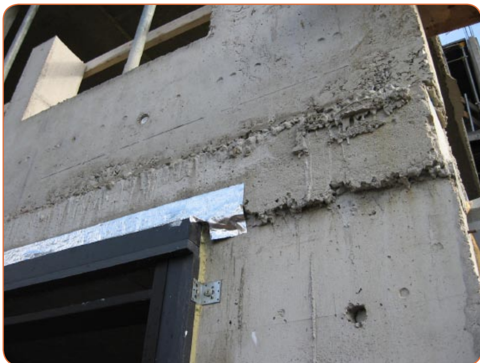
Foto 4. Indien het binnenspouwblad niet vlak is dan zullen zogenaamde 'valse' spouwen ontstaan. Zorg dus voor een vlak binnenspouwblad voordat wordt geïsoleerd.
